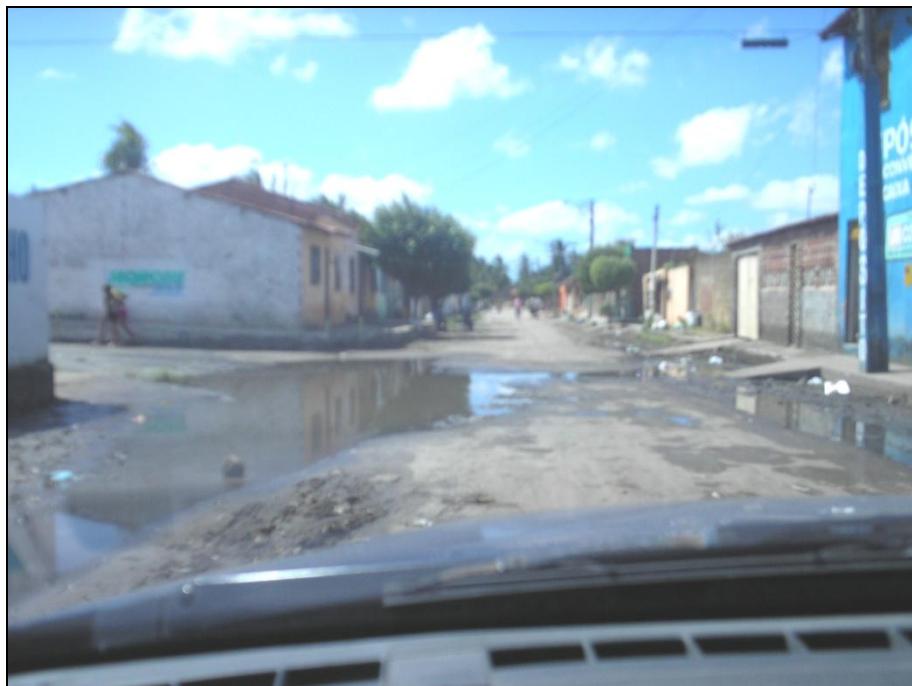
FOTO 5 – Vista da antiga entrada do CEI Dona Benta, substituída após a inauguração, uma vez que alagava por falta de escoamento nos períodos de chuva, impossibilitando o acesso (SER I).
