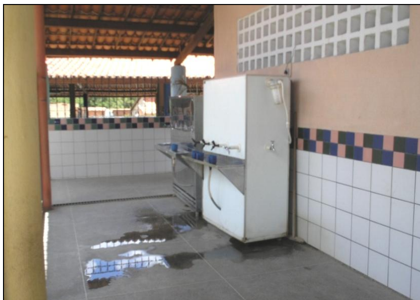
FOTO 23 – Torneira do bebedouro quebrada. Desperdício de água. (CEI Dona Benta).
